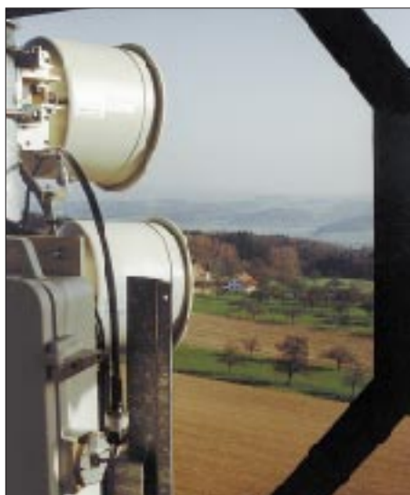
Hochleistungsantenne mit angebautem HF-Teil. Die Verbindung erfolgt durch flexibles Hohlleiterkabel. Fotos: DL1MEH
