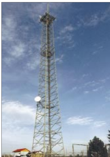
70-m-Mast eines Energieversorgers: Über solche Funkstrecken werden beispielsweise Meßwerte übertragen und Umspannwerke ferngesteuert.
